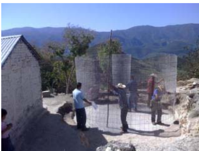
Productores colocando el cilindro de la cisterna de ferrocemento, cerca del techo de la casa para aprovechar el agua de lluvia
