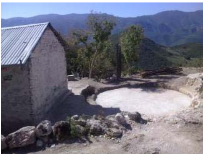
Diseño y trazo para construir la cisterna de ferrocemento para cosechar el agua de lluvia
