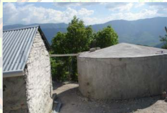
Cisterna terminada con el sistema de cosecha y conducción de agua de lluvia desde el techo al depósito.
